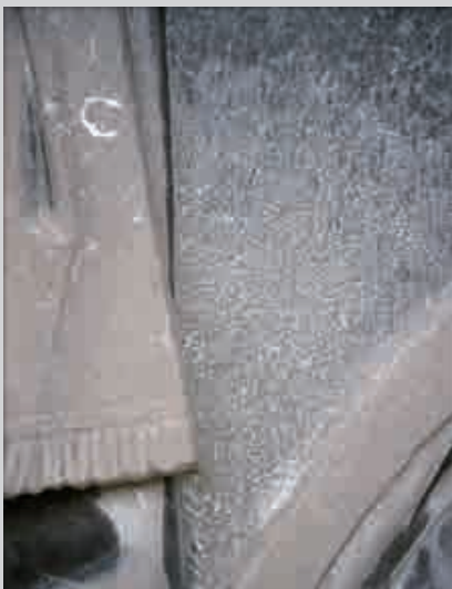
Fig. 2.- Détail d'une fenêtre du premier étage en façade occidentale, partie nord. Calcaire de Meuse, au traitement de surface varié : arc régulièrement ciselé (en bas à droite), fond de l'écoinçon travaillé à la petite broche (en haut à droite), draperie lissée (à gauche), le tout générant un jeu subtil de textures. © Francis Tourneur (2001).
