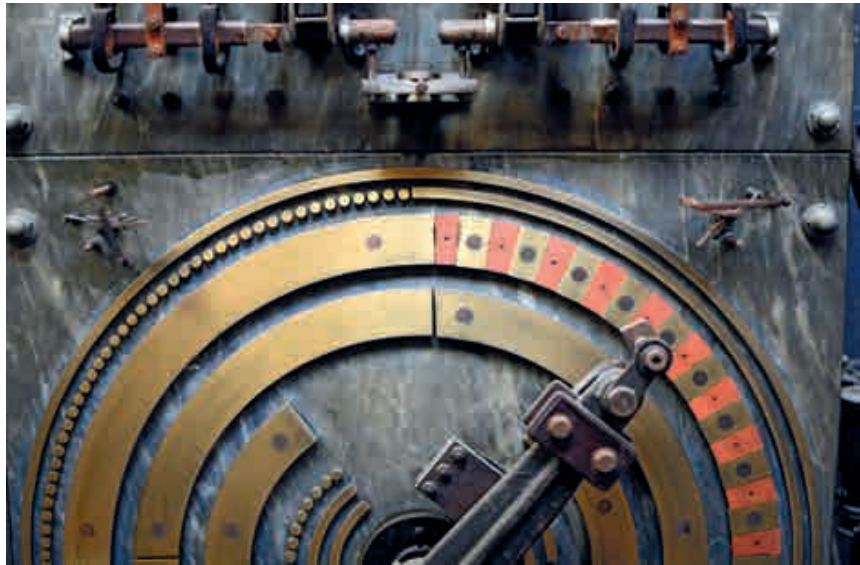
Fig. 27.- Tableau de distribution de la S1. © Eduarda Lopes.
