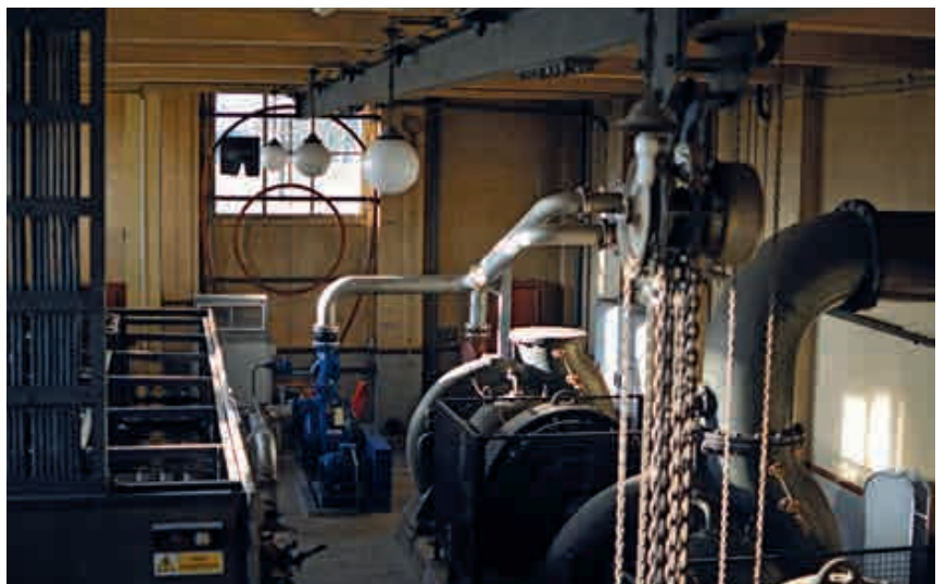
Fig. 16.- Salle des pompes de la S1. © Eduarda Lopes.
