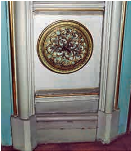
Fig. 56.- Rue Paul Devaux n° 6 : bouche de pulsion d'air chaud du grand salon datant des années 1880. Photo Flavio Di Campli, 2004 ©SPW-AWaP.
