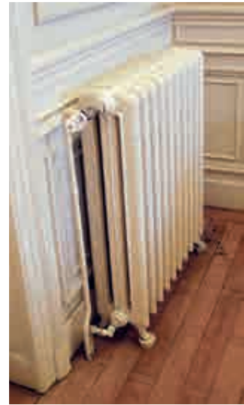
Fig. 58.- Boulevard Piercot n° 44 : radiateur en fonte du salon datant des années 1900. © Nicolas Sougnez, 2018.
