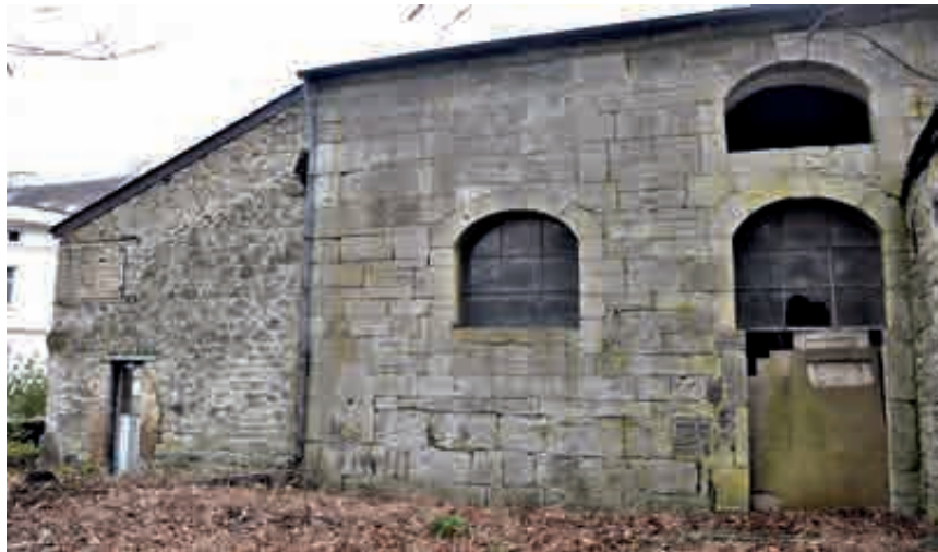
Fig. 25.- Idem, façade occidentale de l'aile septentrionale de la petite ferme, traces de l'appentis primitif de la galerie d'arcades ainsi que des baies en anses de panier de la sacristie, deuxième moitié du XVIII e siècle. © Mathilde Macaux, 2019.
