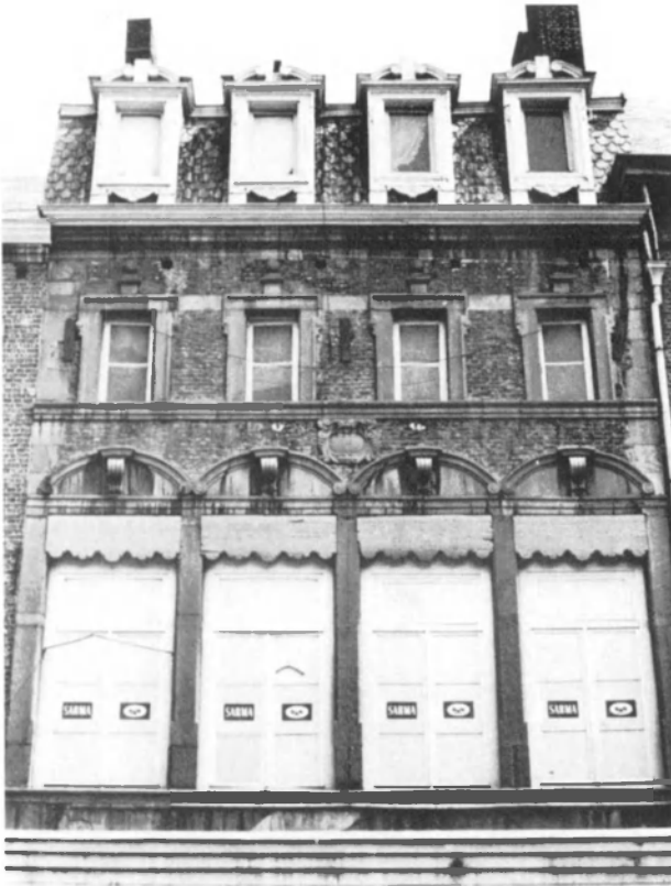
Fig. 4. Maison de 1680, rue de l'Ange, 16. Toiture et lucarnes du XIX e s. L'obturation des baies du premier étage dénature les proportions.
