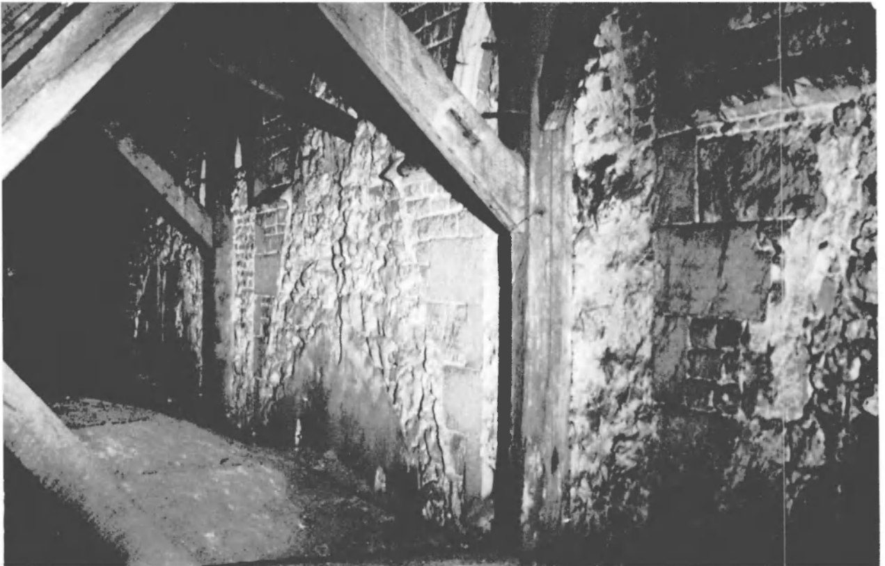
Fig. 8. BAUDOUR, église Saint-Géry, combles du collatéral sud, fenêtres hautes de la nef et traces des pignons et des lambris transversaux des bas-côtés. (Photo J. Huvelle.)
