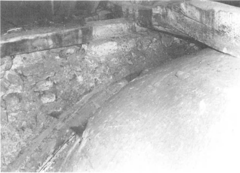
Fig. 5. Partie d'un arc formeret de la première travée du chœur, côté sud, visible dans les combles. Photo de l'auteur.
