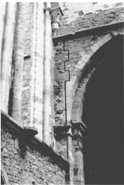
Fig. 17. Angle nord-est du croisillon nord : arrachements et couture verticale.
