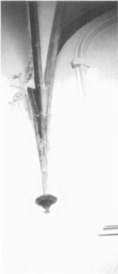
Fig. 7. Amortissement des nervures, à l'entrée du chœur, laissant apparaître l'amorce de nervure de l'ancienne voûte de la nef.
