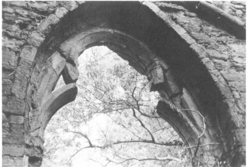
Fig. 29. Aile nord de l'avant-corps : fenêtre géminée de la face nord et détail du formeret.
