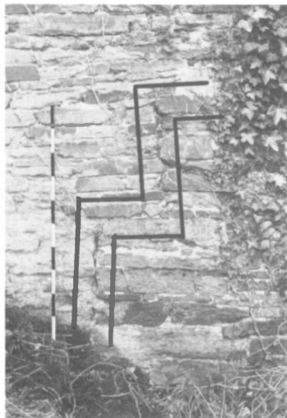
Fig. 6. Face ouest du croisillon nord: couture oblique du 2° niveau.
