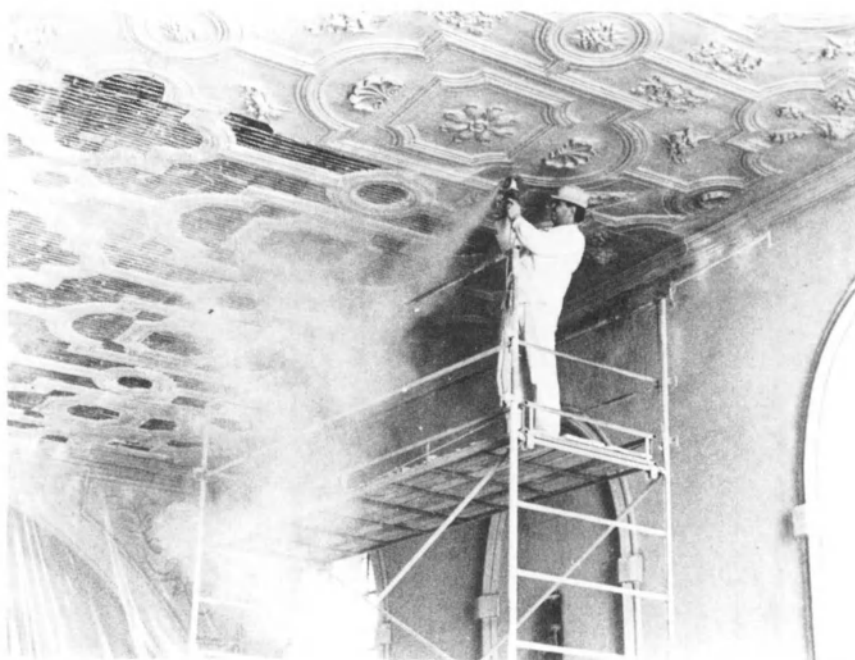
Fig. 13. Travail de découpage et d'enlèvement des parties planes et des motifs du plafond, les moulures restant en place.
