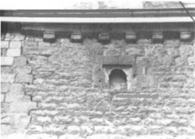
Fig. 9. Détail de la façade latérale : niche, corniche et crevasse. (Photo J. Culot).
