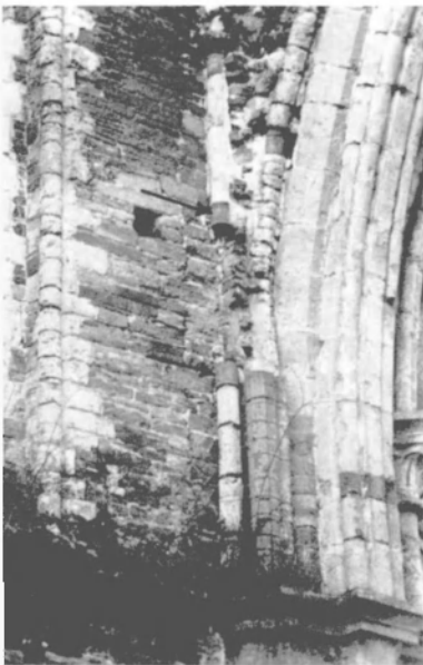
Fig. 8. Angle sud-est du croisillon nord : colonnette de formeret et couture verticale.
