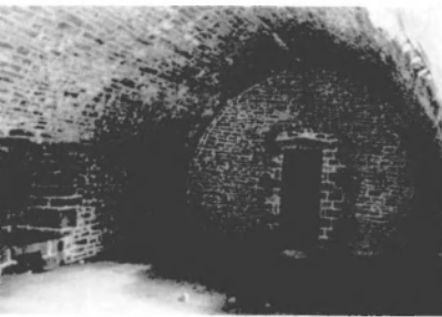
Fig. 78. Le cellier de « la salle » dont la ôute en arc brisé pose sur un cordon de pierre en encorbellement. La porte du fond, qui n'existait pas à l'origine, donne communication avec le saloir. Une meurtrière, creusée en hors d'œuvre permet la surveillance du glacis de la forteresse. C'est sous le sol de cette cave que fut retrouvée la première enceinte de la haute-cour.
