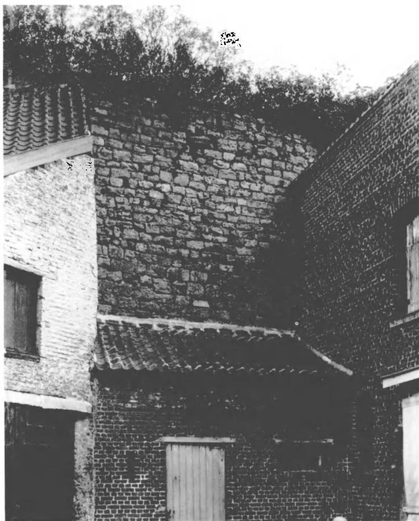
Fig. 75. Le mur de la basse-cour vu de la Cour Saint-Jean. Sans protection, ce mur perd régulièrement de sa hauteur. La végétation envahissante descelle la maçonnerie et crée de sérieux dangers pour le voisinage. Photo A.C.L.
