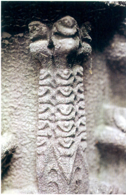
Fig. 44.- Restauration néogothique en petit granit, sur la face sud de la tour; sous les salissures, on sent le grain plus grossier du matériau et la patine plus sombre (cliché Fr. Tourneur, 1996).
