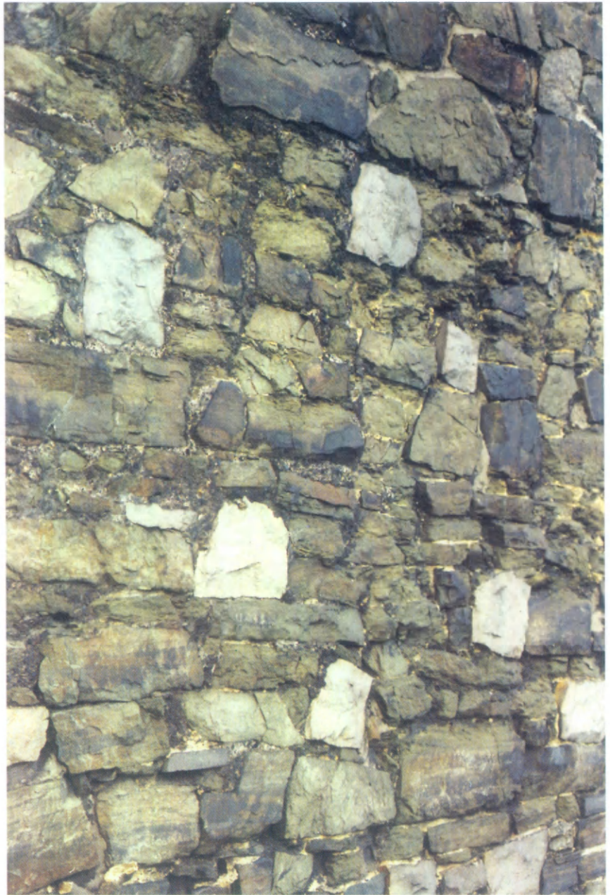
Fig. 5.- Parement du rempart sud-est, sous le parc communal, constitué pour l'essentiel de grès argileux brunâtre extrait des terrains houillers, mal équarri, en éléments de dimensions très variées et peu assisés; s'en distinguent nettement les faces carrées et claires des boutisses en grès de Bray, disposées en damier régulier (cliché Fr. Tourneur, 1994).
