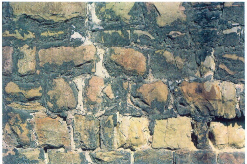
Fig. 36.- Détail du grès houiller de l'avant-corps occidental; salissures étendues jusqu'à des croûtes de sulfatation, altération marquée parfois pulvérulente sont typiques du comportement malheureux de ce matériau (cliché Fr. Tourneur, 1994).
