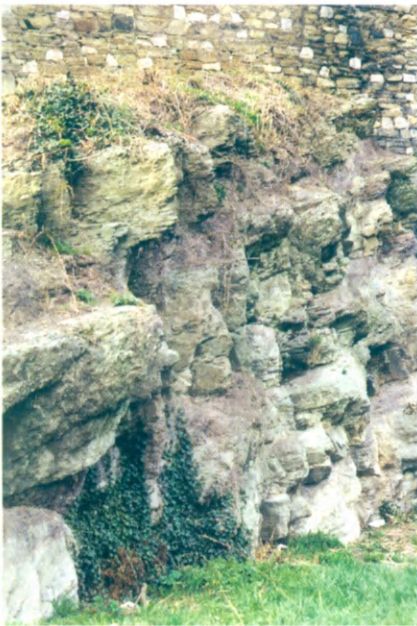
Fig. 3.- Affleurement du Dévonien inférieur sous les remparts du parc communal, constitué d'une alternance de grès verts et de schistes lie-de-vin; ces derniers qui se prêtent mal au façonnage sont rarement utilisés dans les maçonneries, alors que les grès verts ont livré beaucoup de moellons (cliché Fr. Tourneur, 1994).
