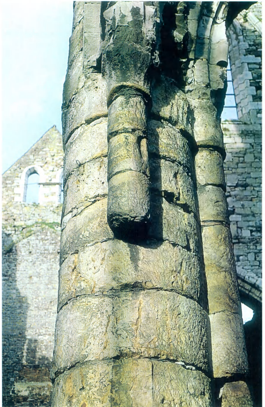
Fig. 23.- Détail de la pile sud-est du transept de l'abbatiale, montrant les gros tambours de grès clair sous le départ des arcs en calcaire; les colonnettes sont constituées par endroits d'excroissances des tambours de la pile, par ailleurs de tambours étirés verticalement, ce qui correspond grosso modo à l'alternance élément en lit / élément en délit des constructions traditionnelles (cliché Fr. Tourneur, 1995).
