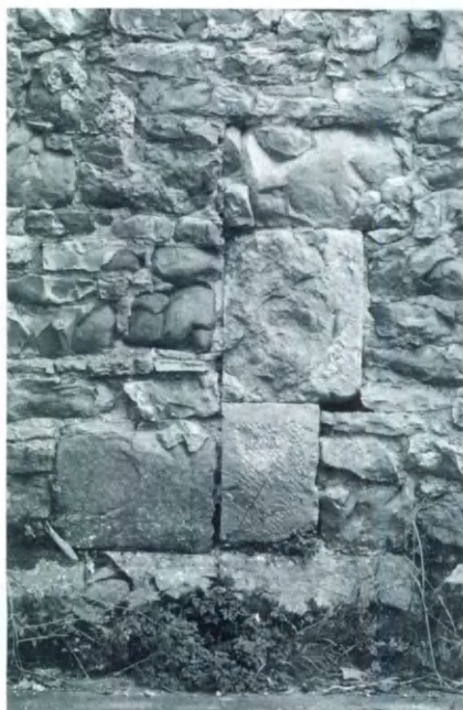
Fig. 30. - Structure A, façade ouest : joint montant.
